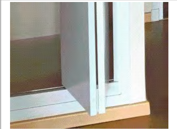
Prélèvement - P2 : Etage 3 / Placard 1 - Dalle de sol - EP- (Présence d'amiante)
